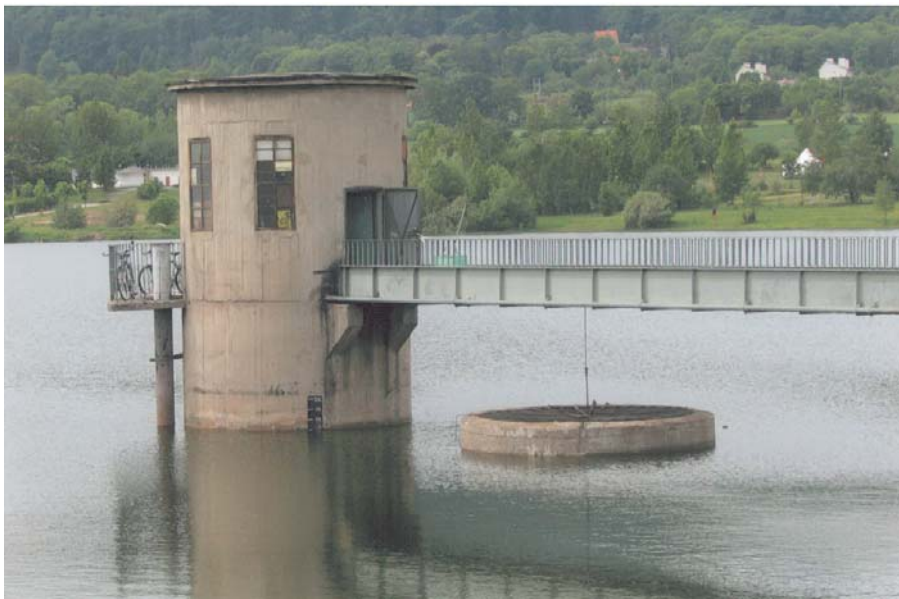
Fot. 12. Widok na wieżę ujęć i wieżę przelewową Photo 12. View on the intake tower and on the overflow tower
