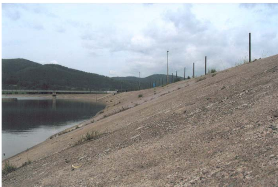
Fot. 10. Żelbetowy ekran na skarpie odwodnej zapory Photo 10. Concrete screen on the upstream dam embankment
