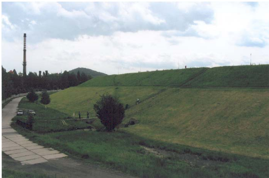
Fot. 9. Zapora ziemna – widok na skarpę odpowietrzną Photo 9. Earth dam – view on the downstream embankment
