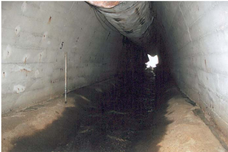
Fot. 15. Przepust pod zaporą – widoczny rurociąg grawitacyjny Photo 15. Culvert under dam – visible gravitational pipeline
