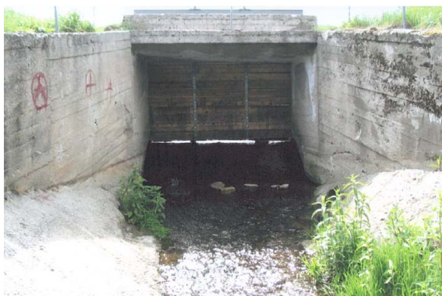
Fot. 2. Ujęcie na potoku Rdzawa – widok od strony wody dolnej Photo 2. Water intake on the Rdzawa stream – view from the downstream side
