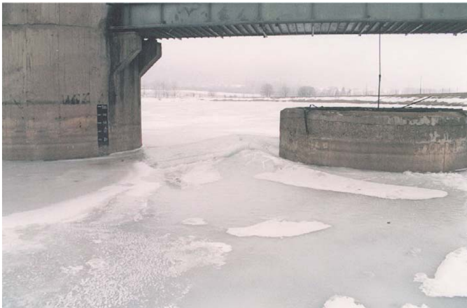
Fot. 14. Wybrzuszenie pokrywy lodowej napierającej na wieżę Photo 14. Ice cover bump pressing on the tower
