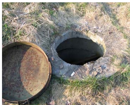
Fot. 5. Studzienka kontrolna nr 2 – Brzeźno Phot. 5. The control well no.2 – Brzeźno
