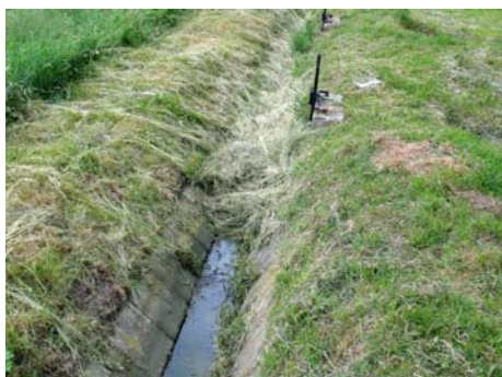
Fot. 10. Błędna konserwacja doprowadzalnika – Brzeźno Phot. 10. The mismaintance supply ditch – Brzeźno
