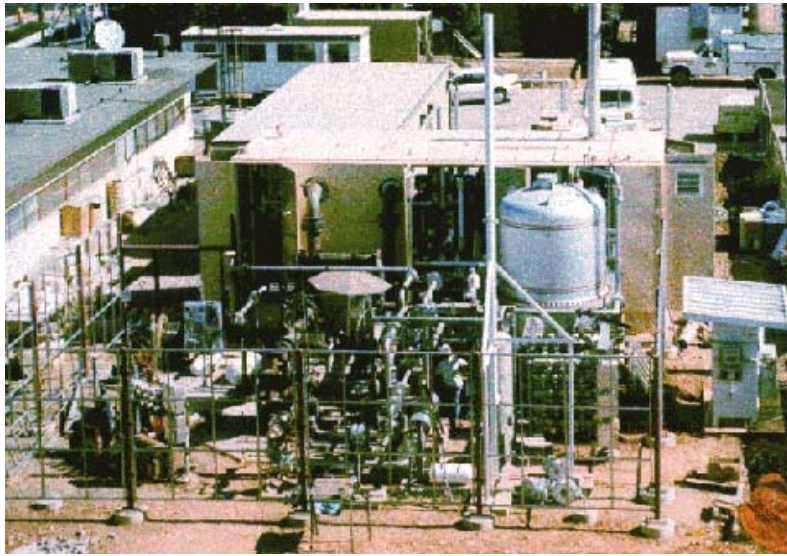
Rys. 5.17. Widok na pilotażową instalację ogniwa MCFC w San Diego Fig. 5.17. View of pilot installation of MCFC fuel cells in San Diego
