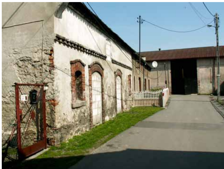
Fot. 48. Stara zabudowa Prawocina, wymagająca rewitalizacji (fot. autorki) Photo 48. Old housing in Prawocin, in need of restoration (photo author)
