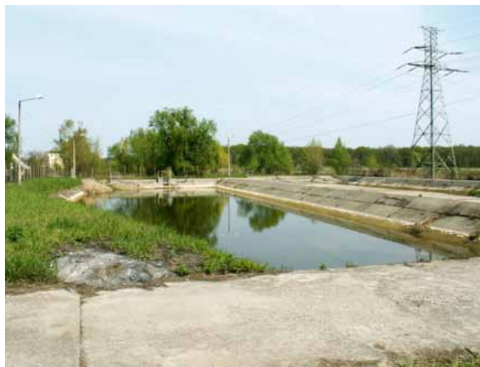
Fot. 182. Osadniki siechnickie przy ul. Polnej (fot. autorki) Photo 182. Siechnice clarifiers in Polna Street (photo author)
