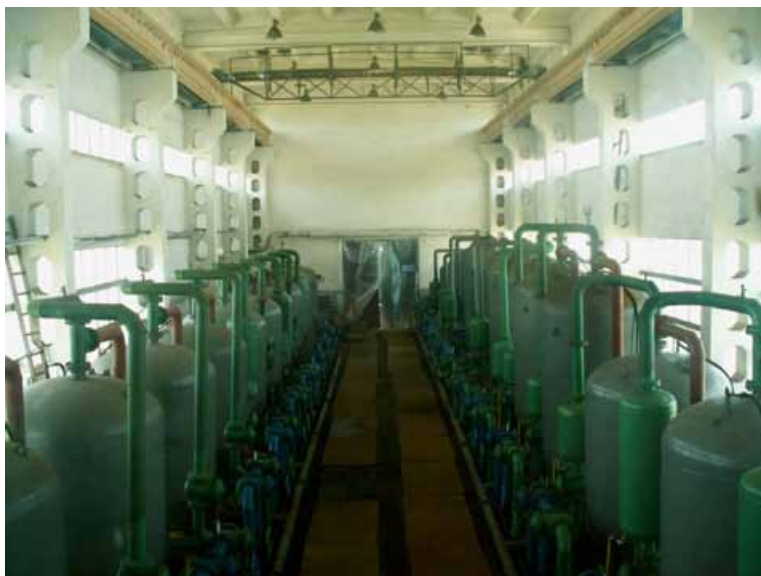
Fot. 102. Wnętrze Stacji Uzdatniania Wody (fot. autorki) Photo 102. Interior of the Water Treatment Station (photo author)
