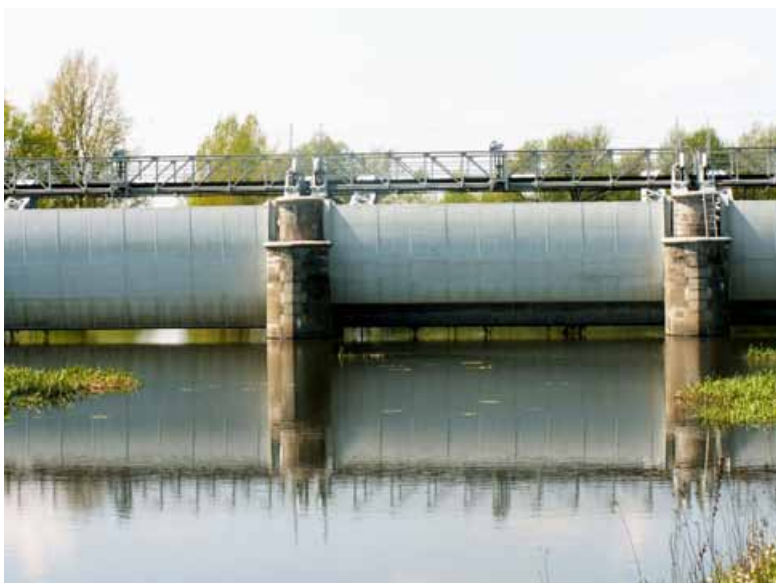
Fot. 169. Urządzenia hydrotechniczne na Oławie (fot. autorki) Photo 169. Hydro-engineering devices on the River Oława (photo author)
