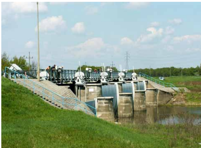
Fot. 170. Urządzenia hydrotechniczne na Oławie – śluza (fot. autorki) Photo 170. Hydro-engineering devices on the River Oława – a sluice (photo author)
