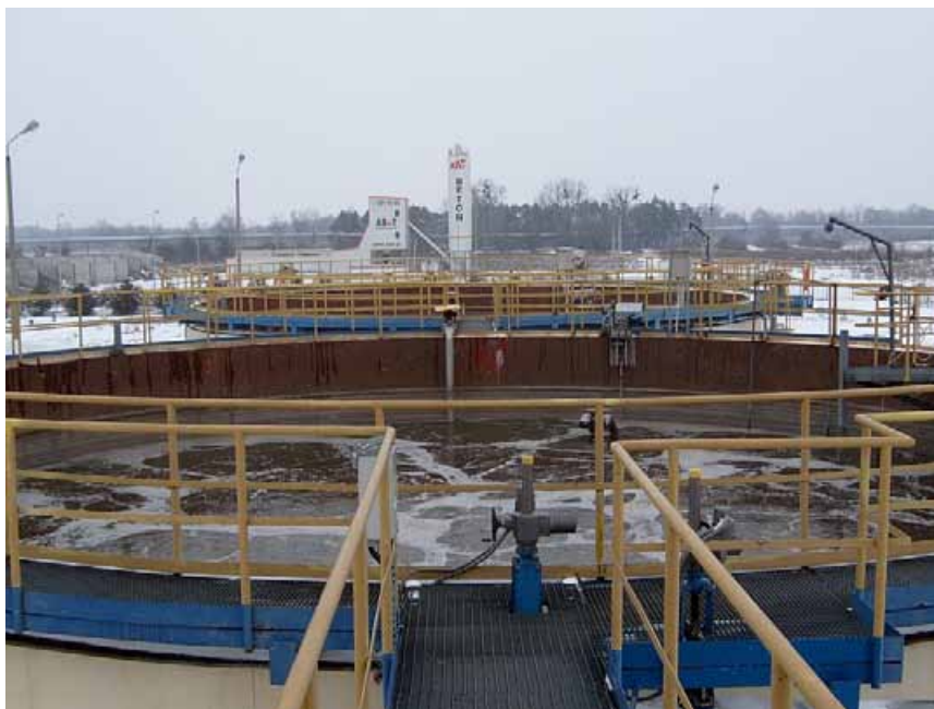
Fot. 104. Zbiorniki oczyszczalni ścieków (źródło: www.zgksiechnice.pl ) Photo 104. Sewage Treatment Plant containers (source: www.zgksiechnice.pl )
