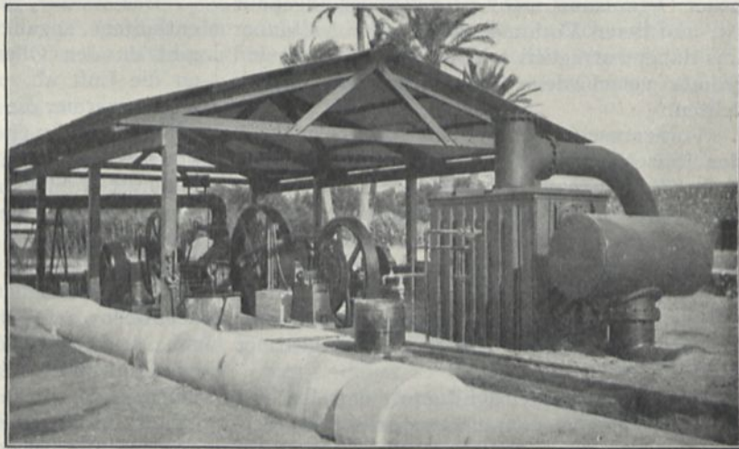
Motor und Pumpe (Vorderansicht).
