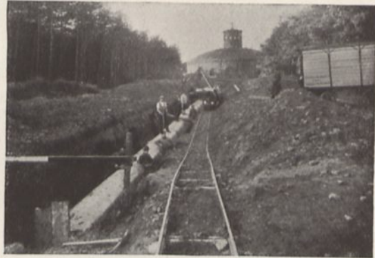
Verlegung der 1000 mm Wasserleitung in 9 m Tiefe bei schwierigsten Bodenverhältnissen am Hochbehälter in Bergshofen bei Dortmund, im Bau 1926 für die Dortmunder Wasserwerks-Gesellschaft m. b. H., Dortmund.
