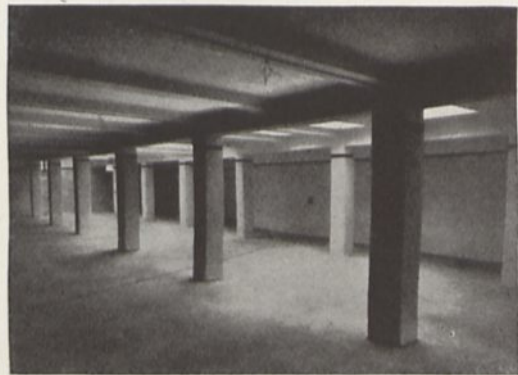
Unterkellertes Hof Boden und Wände gegen Grundwasser isoliert. Decke mit Asphalt abgedeckt.
