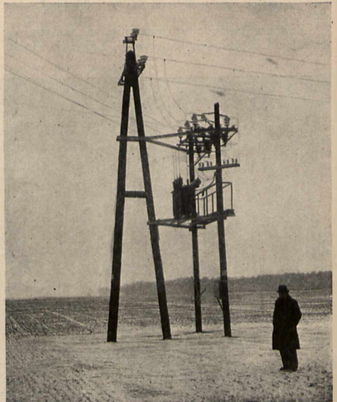
Stacja transformacyjna 30 000/380/220 V o mocy 50 kVA, zasilająca Zakład Psychjatryczny w pow. Gostynińskim.
