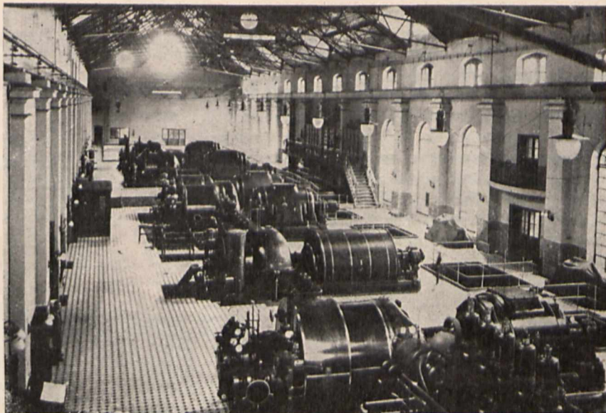
Widok sali maszyn wzdłuż osi.
