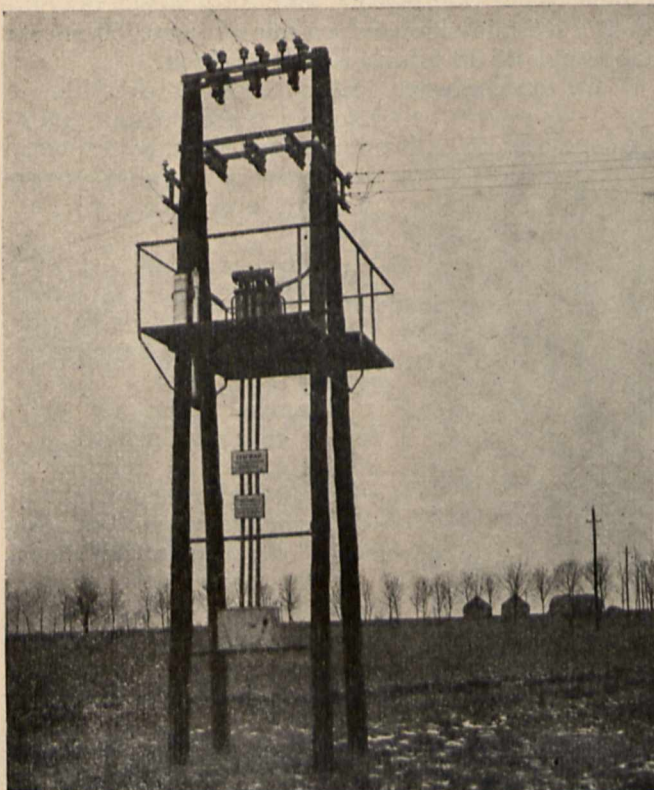
Stacja transformacyjna 6000/380/220 V o mocy 30 kVA, zasilająca cukrownię Ostrowy w pow. Kutnowskim,
