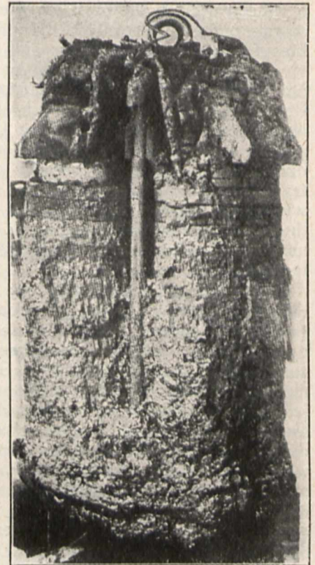
Rys. 9. Rdzeń transformatora, pokryty osadem ze złego oleju.
