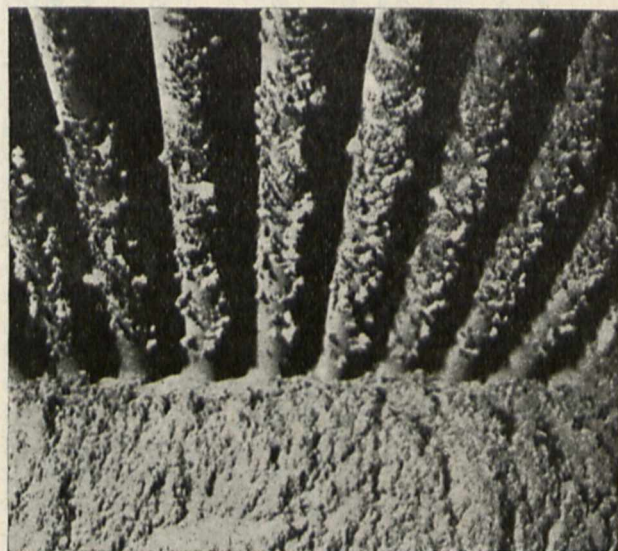
Rys. 12. Dolne opłomki w palenisku, pokryte warstwą sadzy i popiołu.
