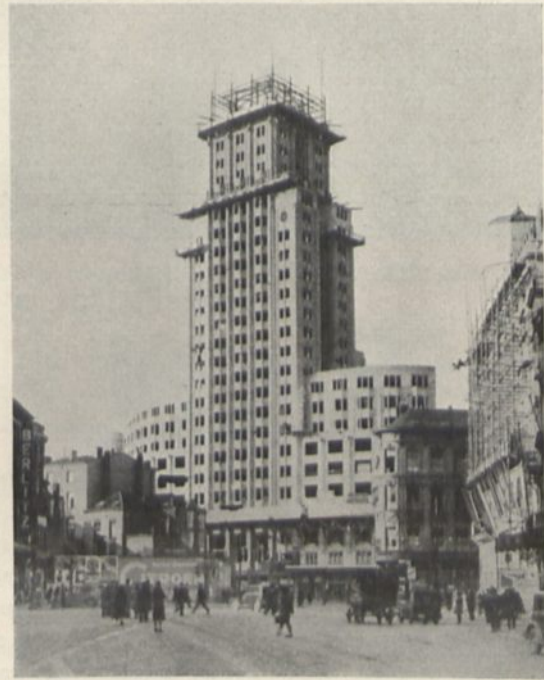
Abb. 453. Hochhaus der Allgem. Bankvereinigung in Antwerpen. Ansicht des nahezu fertigen Baues. Ausführung: DEMAG Aktienges. Duisburg.
