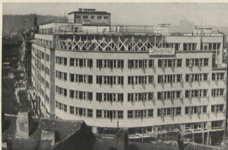
Abb. 4. Hochhaus der Berg- und Hüttenwerksges., Prag. Seitenansicht vor der Fertigstellung. Entwurf des Stahlskelettes: Prof. Dr.-Ing. A. Hawranek. Arch.: J. Rziha. Ausführung: Brückenbauanstalt Carlshütte bei Friedek.
