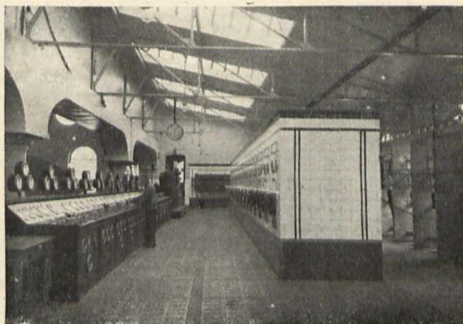
Rozdzielnia w Hucie Pokoju.
