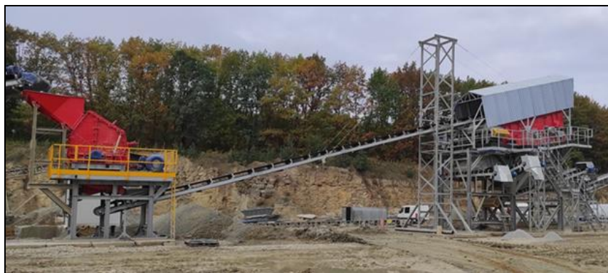
Rys. 4. Widok kruszarki KU 80/120 oraz przesiewacza WSR 3-2,0/6,0 Fig. 4. View of the KU 80/120 crusher and the WSR 3-2.0/6.0 screen
