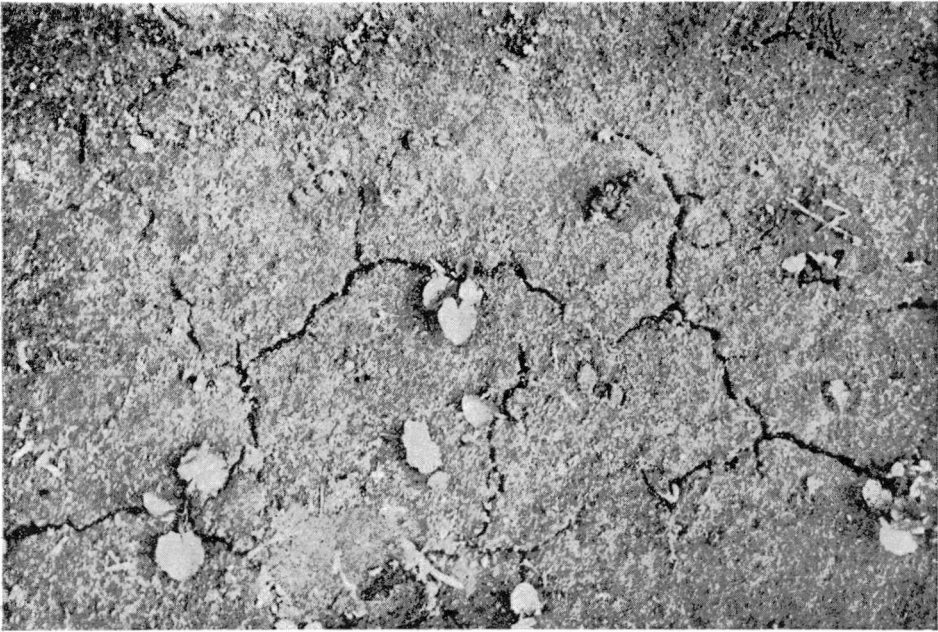
Rys. 1. Spękanie rozmarzającej ziemi ogrodowej. Warszawa.
