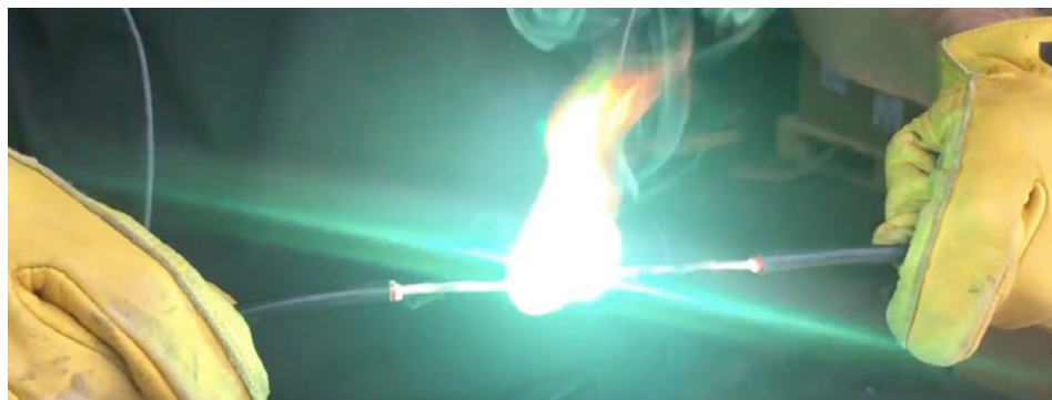
Fot. 1. Łuk elektryczny wywołany na instalacji fotowoltaicznej o mocy 1 kW [4]
