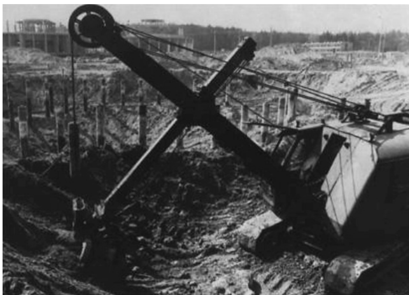
Ryc. 5. Roboty ziemne ZG „Rudna”, w głębi krąg mrozeniowy i rotundy transformatorów (zdjęcie archiwalne)
