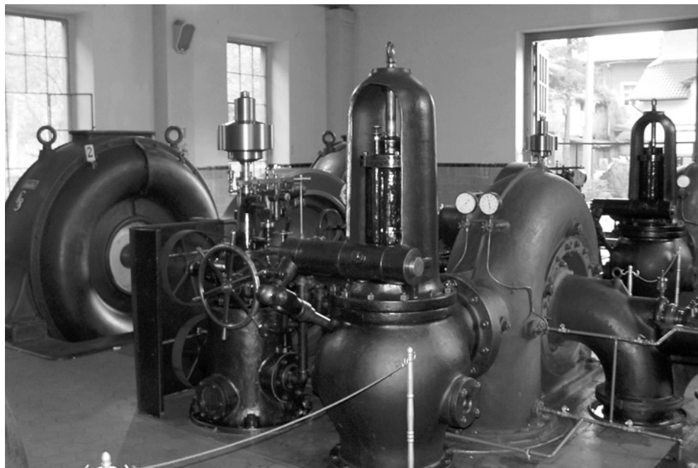
Ryc. 3. Hala maszyn elektrowni w Lubachowie (fot. autor)
