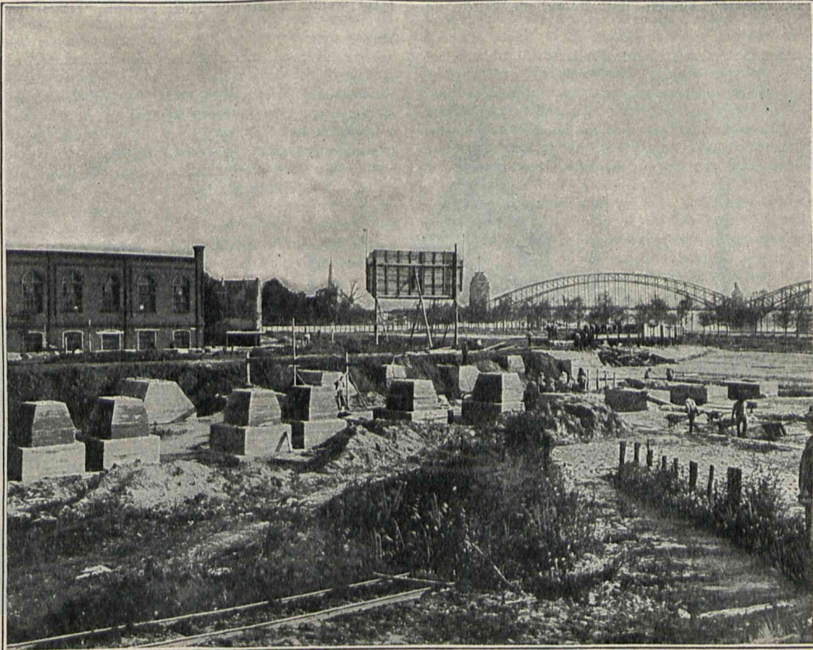
Betonfundamente für die Düsseldorfer Ausstellung 1902. Rechts im Vordergrund das der zeitweiligen Ueberfluthung ausgesetzte Sumpfgelände.
