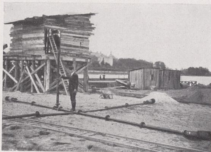
Abb. 51. Luftabführungsrohre, die bei den Widerlagern in die Sohle der Arbeitskammern eingebaut wurden.
