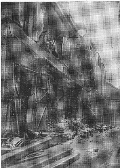
Front rozdzielni na 35 kV; kanały wentylacyjne ocalały tylko w końcowej części budynku
