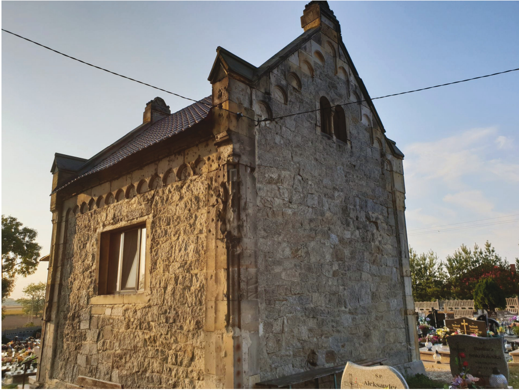
Il. 9. Widok uszkodzeń kamieniarki i zdewastowanego układu okien w mauzoleum rodu von Mutius. Stan w 2018 r. (fot. S. Wróblewski)
