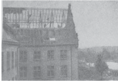
Zniszczony dach budynku A-1
